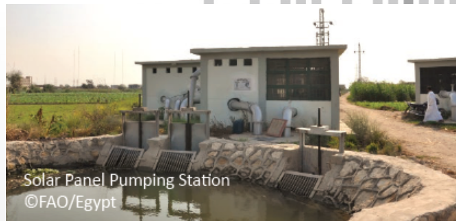
Σύστημα άντλησης υδάτων στο Νείλο, Αίγυπτος
